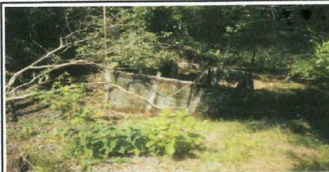
Foto 6: Baño fuera de servicio.
