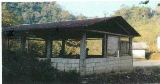
Foto1: Techo con goteras y en deterioro
