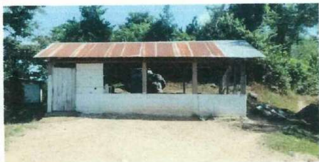
Foto 5: Techo y falta de una puerta de metal
