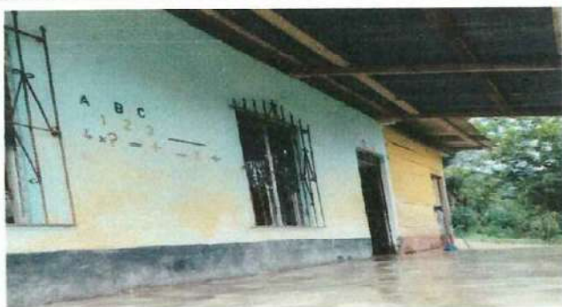
Foto 3: Paredes sucias por la falta de pintura.
