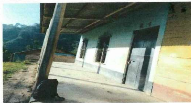
Foto 2: Techo y puerta oxidadas
