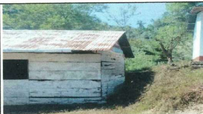
Foto 4: Cocina en condiciones inadecuadas
